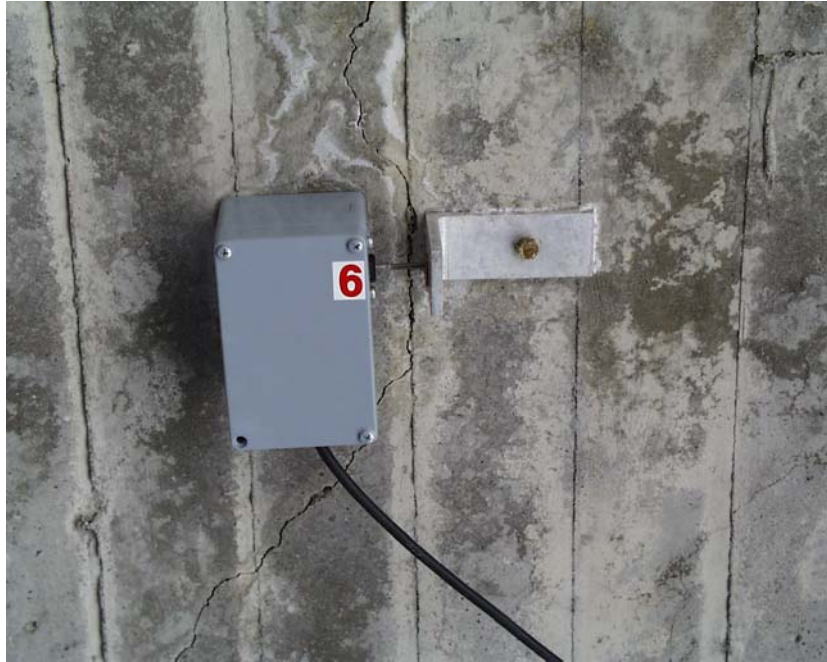
Figure 3 : Potentiomètre mesurant le souffle d'une fissure
