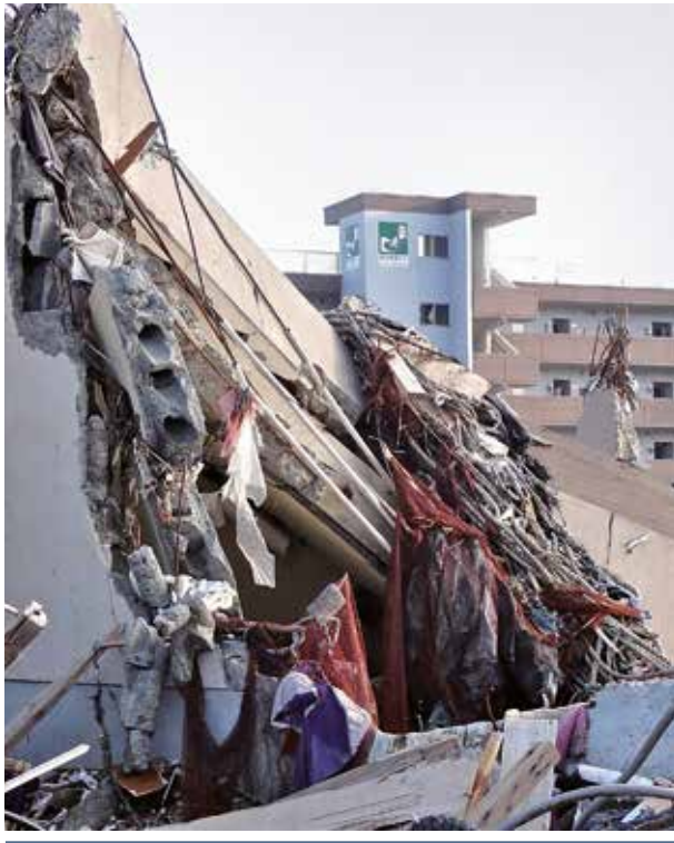
De hauts bâtiments en béton armé ont servi de refuge pour une évacuation en hauteur lors du tsunami survenu au Japon le 11 mars 2011, sauvant ainsi de nombreuses vies. Minami Sanriku, Japon. Crédit photographique : CIIT
