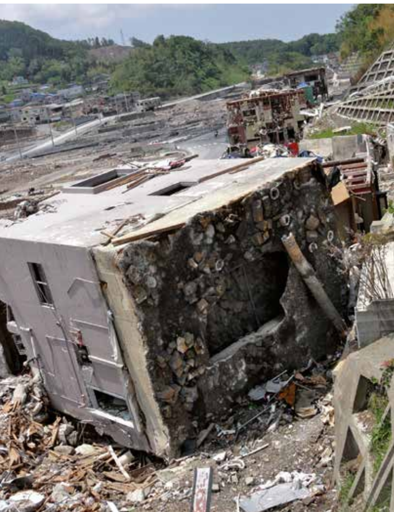
Des masses d'eau atteignant plus de 10 mètres de hauteur et déferlant à plus de 6 mètres par seconde ont renversé et traîné des bâtiments de trois étages sur près de 50 mètres lors du tsunami qui a frappé le Japon le 11 mars 2011
