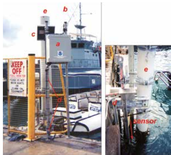
Estación del nivel del mar en Rarotonga, puerto Avarua en las islas Cook. El equipamiento electrónico de fibra de vidrio (a) antena, (b) panel solar fue instalado en un muelle. El conducto (d) que contiene los cables que conectan el sensor, ubicado a una profundidad de 1,5 m bajo el nivel de la bajamar, a la plataforma de colección de datos que contiene el equipamiento electrónico mostrado arriba, fue unido externamente a un tubo que contenía el sensor (e).
