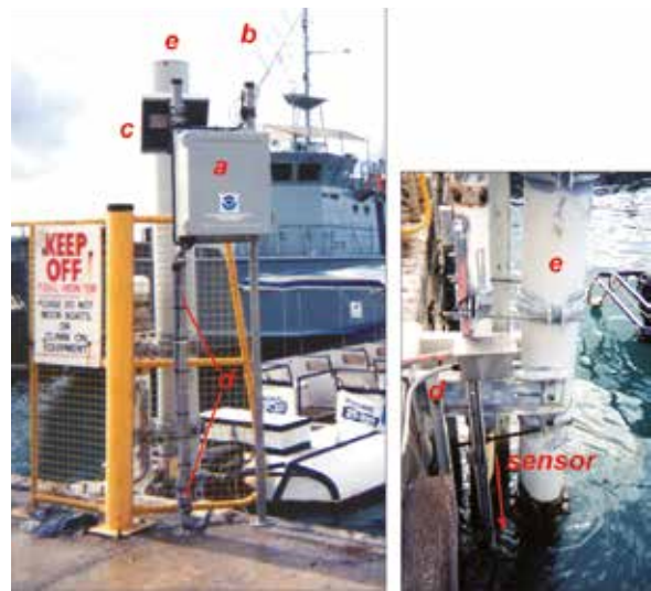
Estación del nivel del mar en Rarotonga, puerto Avarua en las islas Cook. El equipamiento electrónico de fibra de vidrio (a) antena, (b) panel solar fue instalado en un muelle. El conducto (d) que contiene los cables que conectan el sensor, ubicado a una profundidad de 1,5 m bajo el nivel de la bajamar, a la plataforma de colección de datos que contiene el equipamiento electrónico mostrado arriba, fue unido externamente a un tubo que contenía el sensor (e). Cortesía del Centro del Nivel del Mar de la Universidad de Hawái.
