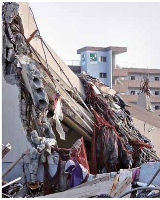
Durante el tsunami de Japón del 11 de marzo de 2011, muchas personas salvaron la vida gracias a edificios altos de hormigón armado que sirvieron como refugio para la evacuación vertical, Minamisanriku (Japón). Fotografía por cortesía del ITIC.
