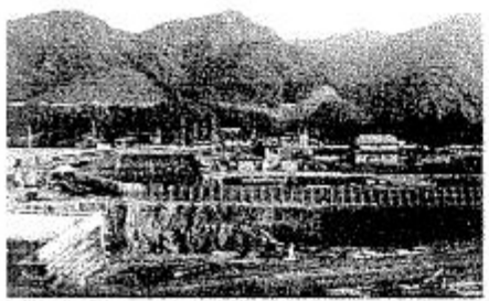
代替地の1つ、川原湯地区には数軒の家が建っていた。ハッ場は急峻な山に挟まれ平地が少ないため、山を切り崩し、谷を埋めてムリヤリ宅地を造成した。手前では代替国道の工事が進んでいる
