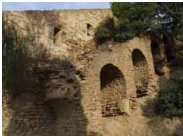
Malgré son abandon, le mur rempart continue à entourer le centre historique de Dellys. Sa restauration et sa mise en valeur permettra aux habitants et aux visiteurs de réaliser une ballade culturelle.
