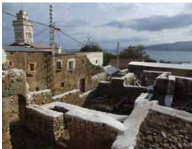
Les interventions d'urgence pour consolider le bâti ancien après le séisme de 2003 montrent l'engagement des autorités pour la sauvegarde de la ville.
