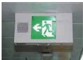
誘導音付点滅型避難口誘導灯
