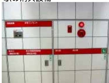
駅の消火設備
