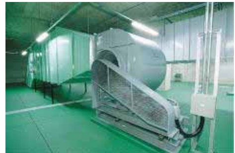
トンネル給気ファン
