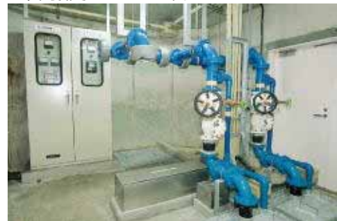
中間排水ポンプ室内
