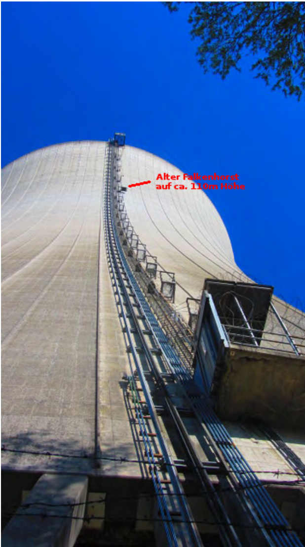
Kühlturm KKW Philippsburg
