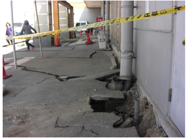
写真 6 西代地区大型商業施設における周辺地盤の沈下と駐車場アスファルト路面の損壊
