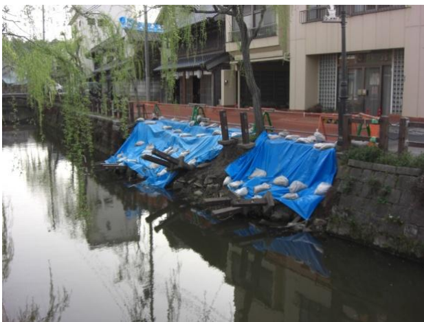
写真23 小野川護岸部の損壊
