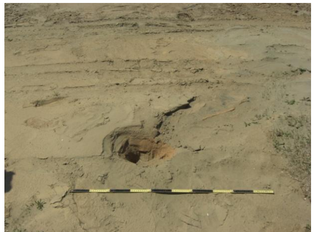
写真4 本新土手（右岸）における液状化現象による噴砂
