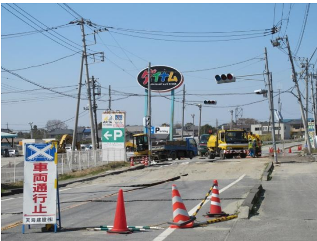
写真 7 西代地区大型商業施設周辺における道路の損壊と電柱の傾斜
