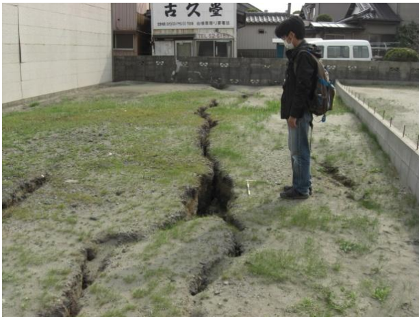
写真 19 下川岸付近における亀裂 幅 30～40cm、長さ 8m 程の亀裂が生じている。
