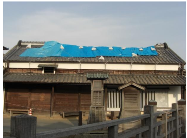
写真22 家屋屋根瓦の損壊（伊能忠敬旧宅：本町）
