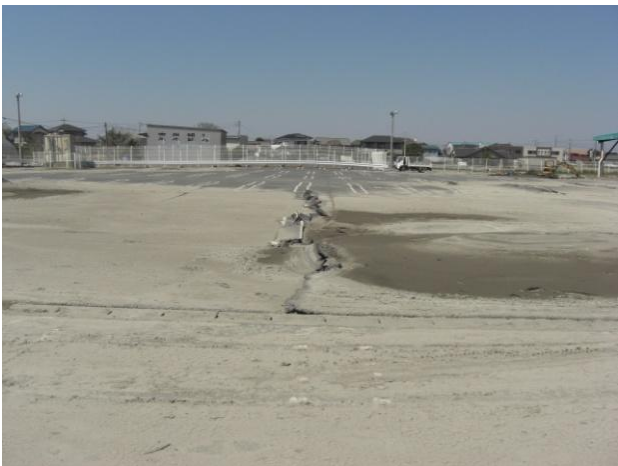
写真 9 西代地区駐車場における亀裂と噴砂
