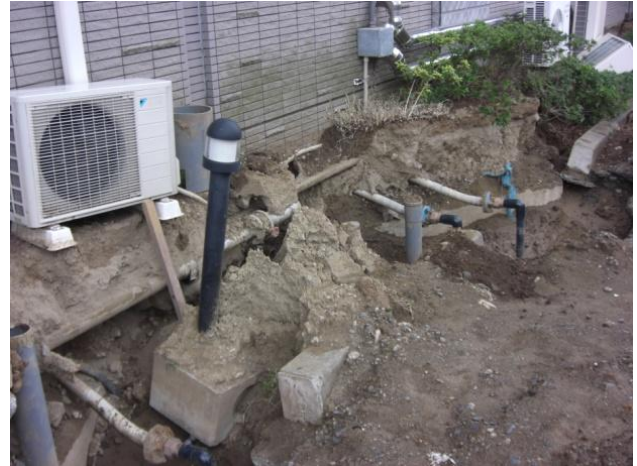
写真 13 液状化現象による地盤沈下
