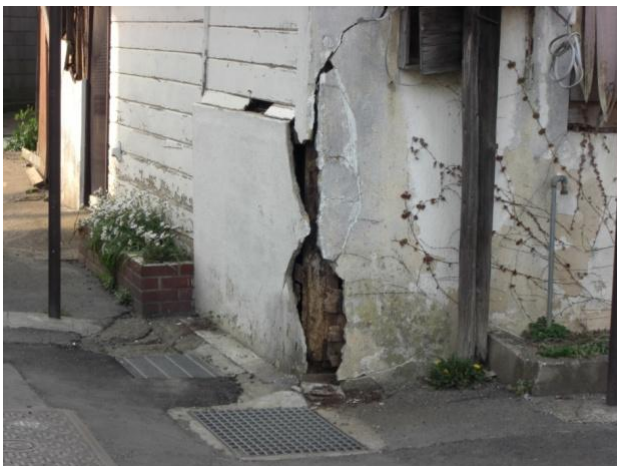
写真21 家屋側壁の損壊（新上川岸）
