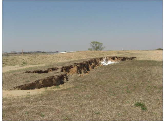
写真2 本新土手（右岸）の亀裂と小崖
