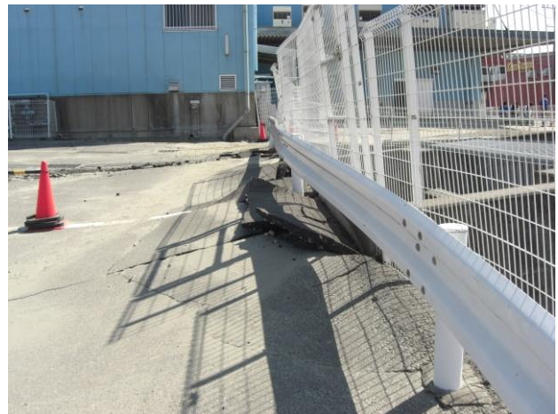
写真 10 西代地区駐車場アスファルト路面とフェンスの損壊
