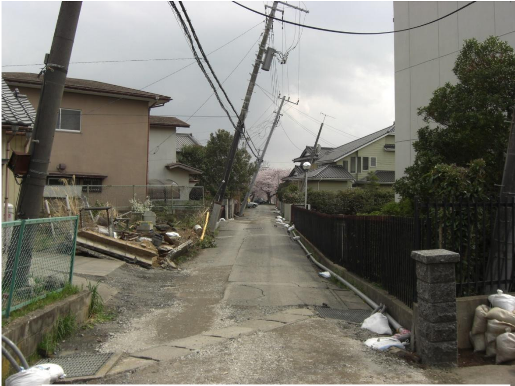
写真 16 水郷大橋町付近における電柱の傾斜と地盤沈下 構造物が沈み込み（写真右手）、電柱が同じ方向に傾斜している。
