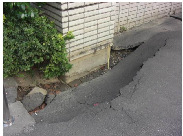
写真24 液状化現象による地盤沈下 40cm 程地表が沈下し、構造物の抜け上がりが生じている。
