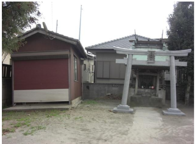
写真 20 下川岸付近における構造物の傾斜
