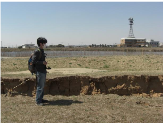
写真3 本新土手（右岸）の亀裂と小崖 小崖の比高は20~40cm程度。
