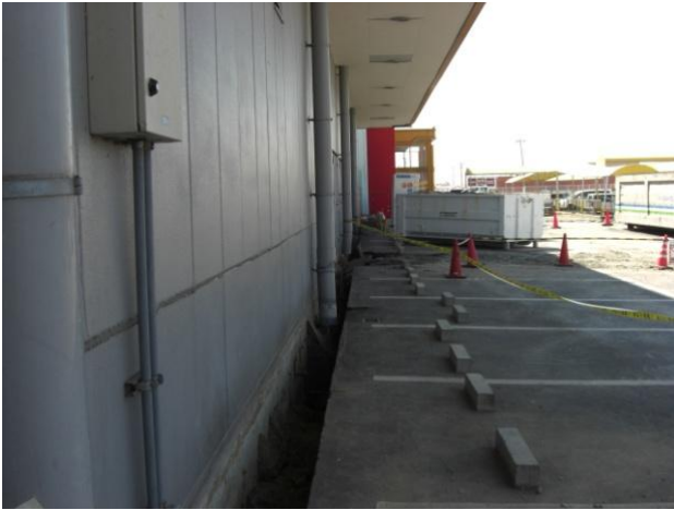
写真 5 西代地区大型商業施設における建造物の沈下
