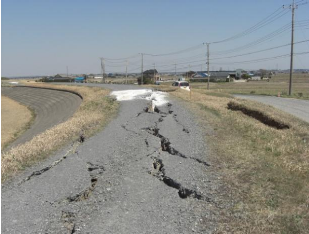
写真1 本新土手（右岸）の亀裂と小崖 亀裂は稲敷大橋付近まで断続的に続く。
