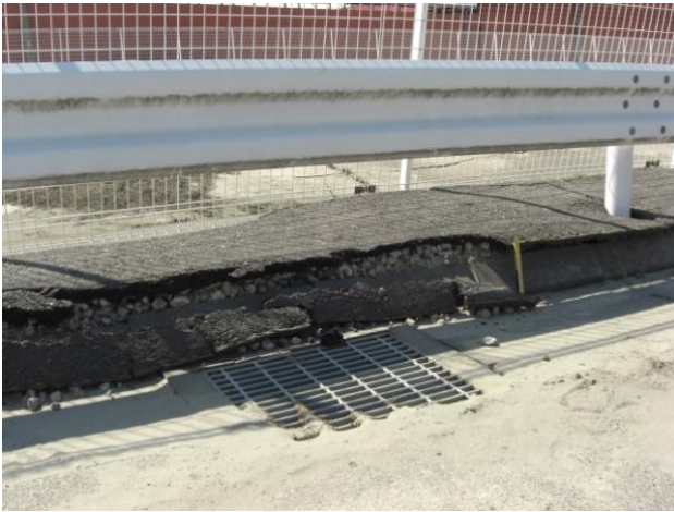
写真 11 西代地区駐車場における地盤沈下により生じたと思われる段差
