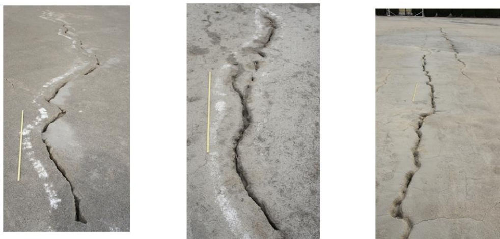
図4 野球グラウンドおよびサッカーグラウンドに残る亀裂
