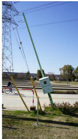
図11 地震により傾いた鉄柱
