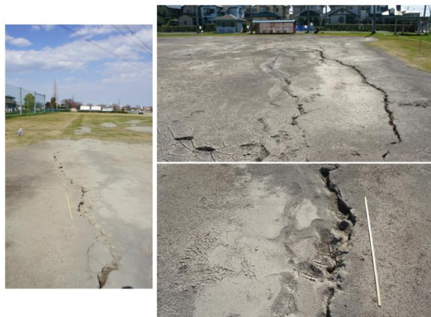
図8 運動グラウンドの亀裂と噴砂の跡
