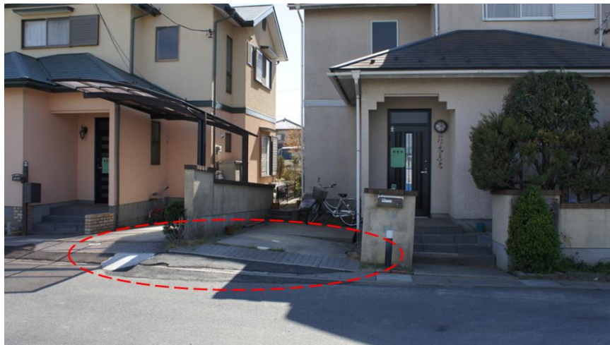
図10 液状化により傾いた住宅
