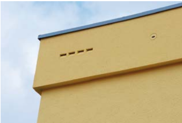
Abb. 5: Fledermaussteine (links) und Mauersegler-Niststein (rechts), eingebaut in den gedämmten Attikabereich eines Flachdaches (Foto: Sylvia Weber).
