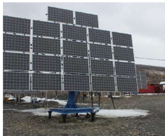
Автоматический солнечный трекер мощностью 10 кВт в п. Ючюгей Оймяконского улуса
