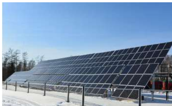
Автономная солнечная электростанция мощностью 60 кВт в п. Батамай
