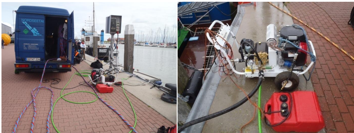
Abb. 15: Die mobile Einheit des Caviblasters wird mit dem Klein LKW transportiert.
