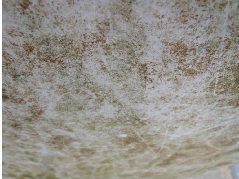
Abb. 50: Grünalgenreste auf der Panadur Testplatte nach der zweiten Reinigung mittels Caviblastler.
