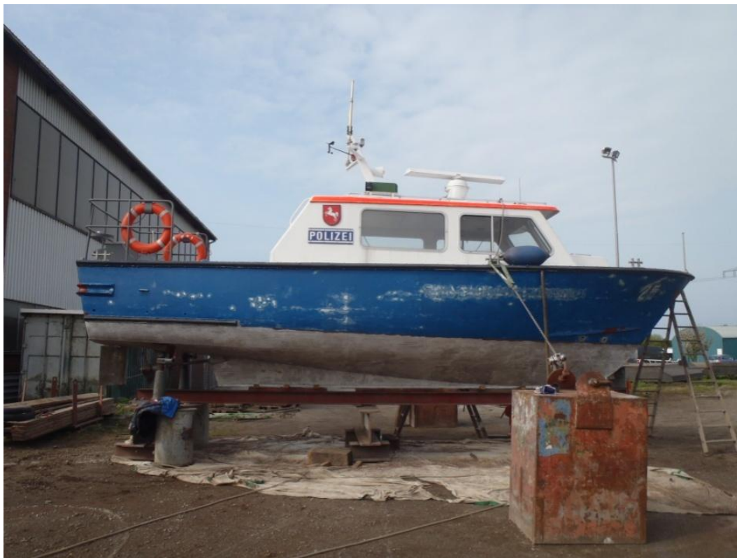
Abb. 114: W16 in der Werft in Emden, Entschichtung und Vorbehandlung zur Beschichtung mit der reinigungsfähigen Beschichtung CleanTec von Wohlerlert.
