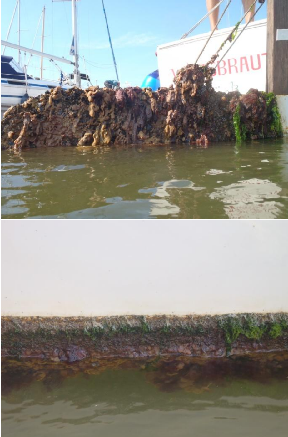
Abb. 72: Mächtiger Bewuchs auf dem Ruder der Windsbraut (oben) und auf dem Rumpf (unten).
