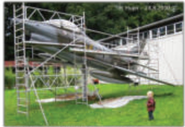
Der abschließende Klarlackschutz wird aufgetragen, der Projektleiter schaut mit seinem Enkel Miró nach den Arbeiten
