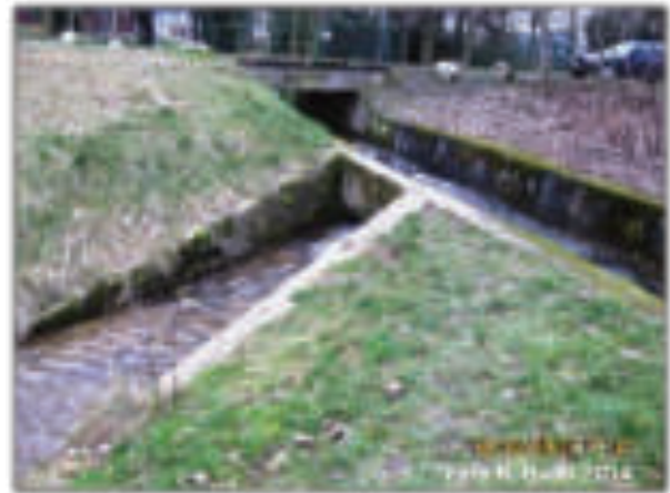
Der meisterrunde Wasserteiler für den großen Werkgraben
