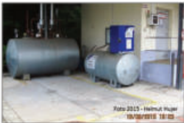
Die Tankanlage von 1995 für den Anbaugeräteprüfstand im Gebäude 19 und davor die Fahrzeugtankstelle von 2004
