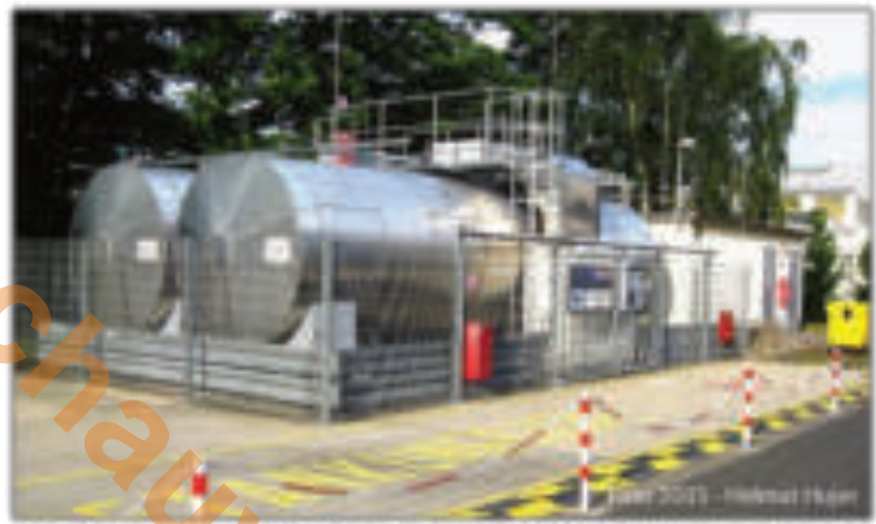
Die 2004 errichtete Tankanlage mit zwei 50.000 Liter-Zweikammertanks
