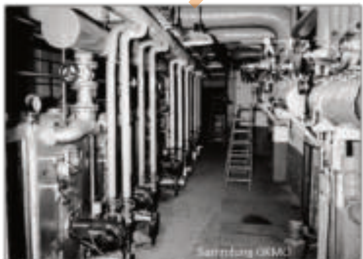
Kesselhaus 1 um 1961, links die Kessel K1 bis K7
