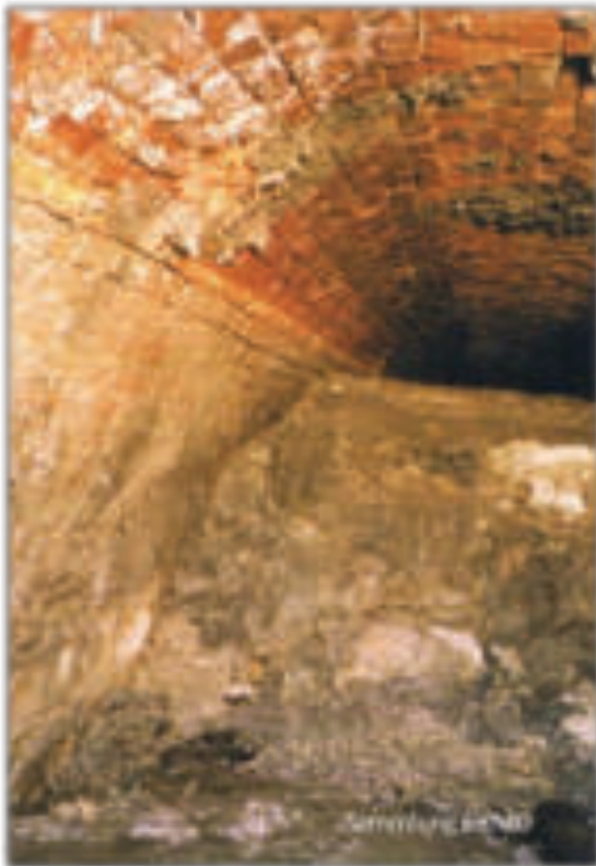
Der 1986 wiedergefundene Ablaufkanal der Steinmühle, hoch angefüllt mit ölhaltigen Ablagerungen
