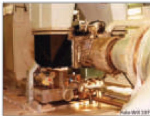
2 MW-Notstromaggregat mit TF35-Gasturbine in Rom
