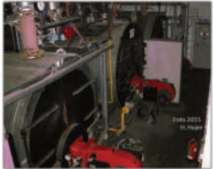
Heizzentrale mit den drei Kesseln von 1974, 1966 und 1972
