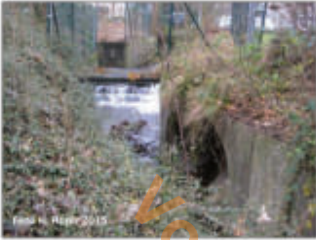
Kanaleinmündungen unterhalb der Straße Borkenberg
