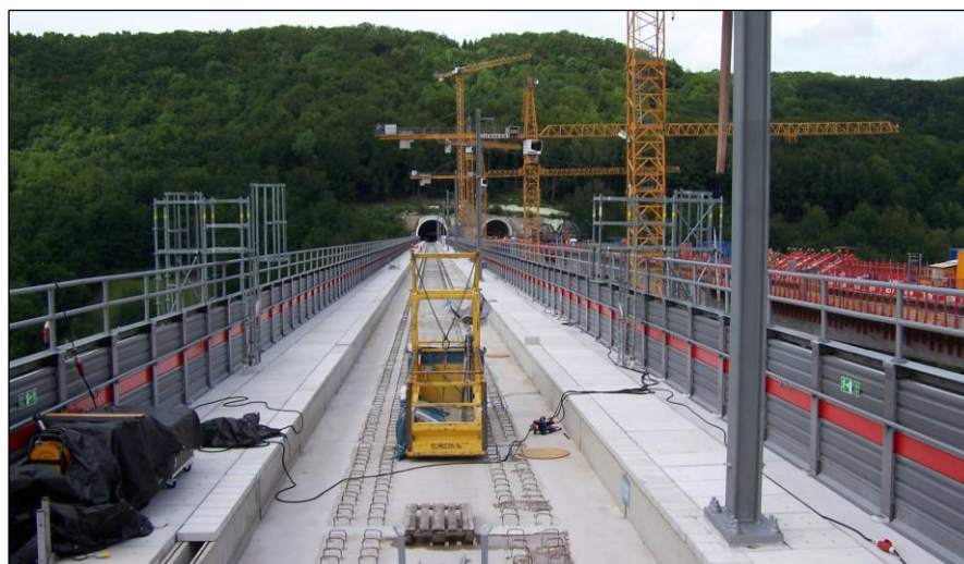
Die beiden Überbauten der Filstalbrücke sind fertiggestellt, Blick talwärts in Richtung des Boßlertunnels; Foto: Gunther Ellwanger.
