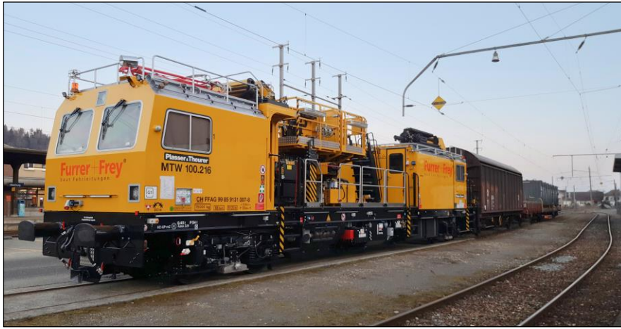
Zur Montage von Oberleitungen hat Furrer+Frey 2015 einen Motorturmwagen der Bauart MTW 100.216 von Plasser & Theurer in Dienst gestellt.
