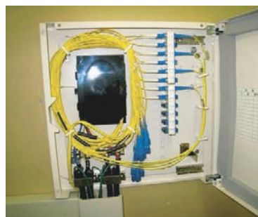
図8 機器室の成端箱から現場設備への光ケーブル
