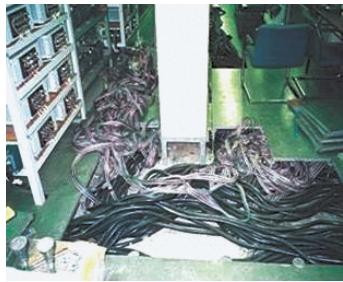
図1 機器室の信号ケーブル
