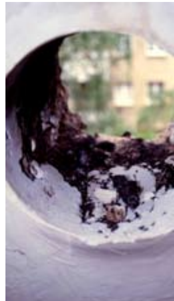
Öffnung von Gasaußenwandheizer mit Fledermauskot © NABU-Archiv
