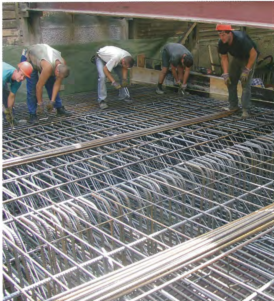
Die Arbeiten gehen Hand in Hand: Vor dem Betonieren der Bauwerksdecken wird die Stahlbewehrung eingeflochten.
