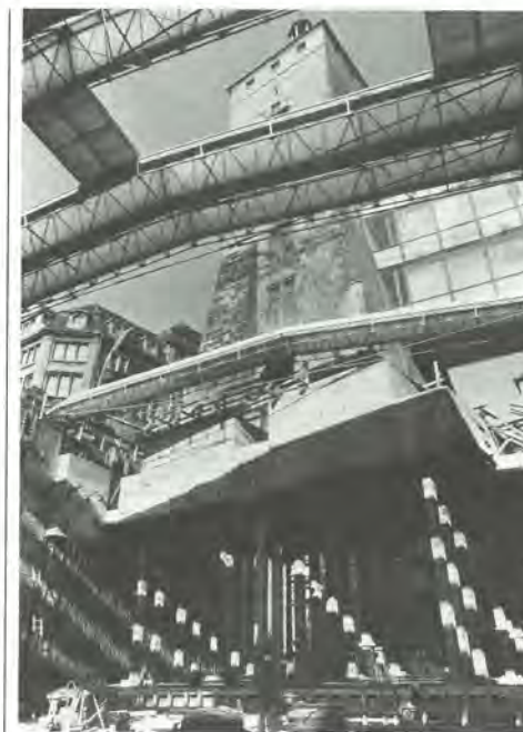
Der Weiße Turm mit seinen 4500 Tonnen Gewicht ruhte auf Pfehlen, bis die Last auf den fertigen U-Bahn-Tunnel umgesetzt werden konnte.
