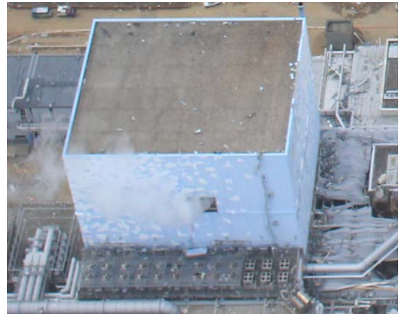
2号機ブローアウトパネルの開放状況
