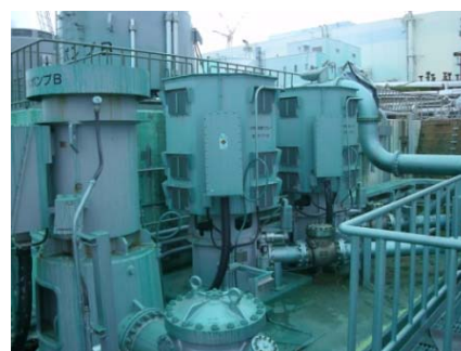
1号機格納容器冷却海水系ポンプ
