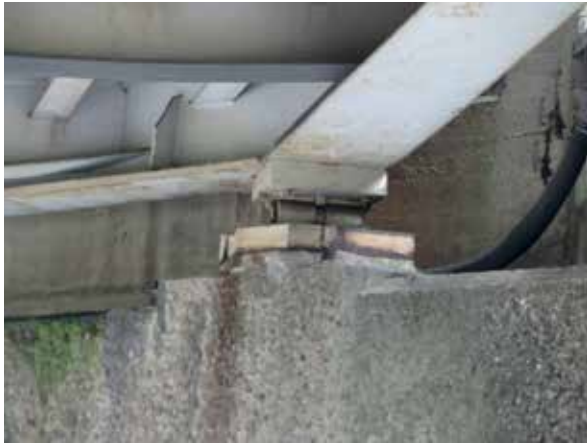
18 Bestandsrollenlager mit Aussteifung © Maurer AG
