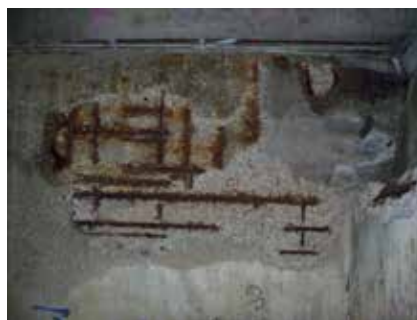
9 Bewehrungskorrosion unter einer Autobahnbrücke der A 661 bei Frankfurt am Main © Karl-Heinz Wellmann
