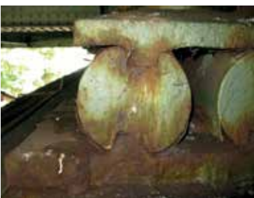
5 Rollenlager mit Korrosionsschäden © Maurer AG
