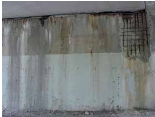
6 Abplatzungen und massive Korrosion im Tiefpunktbereich der Lagerbank © ASFINAG Bau Management GmbH
