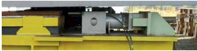
12 Verschublager aus der Nähe © Landesbetrieb Mobilität Rheinland-Pfalz
