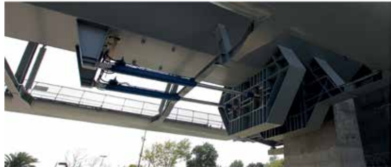
11 Einbausituation: Verriegelung © Astaldi Gülermak
