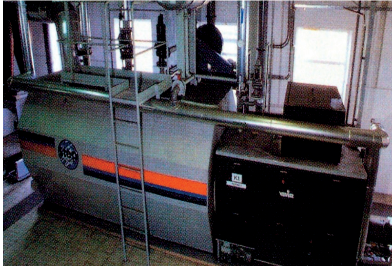
Kotel spalující slámu
