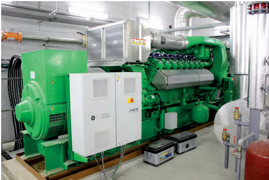
Kogenerační jednotka velkých výkonů – celkový pohled
