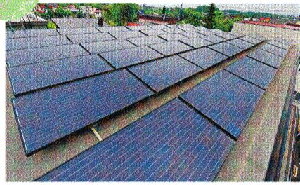
搭載しているソーラーパネルは7.7kW。かなりの大容量です。
