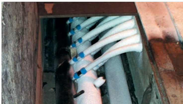
Пластиковые соединения труб площадки к распределительному трубопроводу и главному коллектору (с термоизоляцией).
