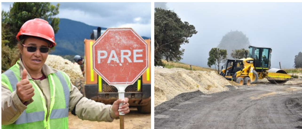
Fuente: Fuente: Unidad Administrativa de Rehabilitación y Mantenimiento Vial -UMV
