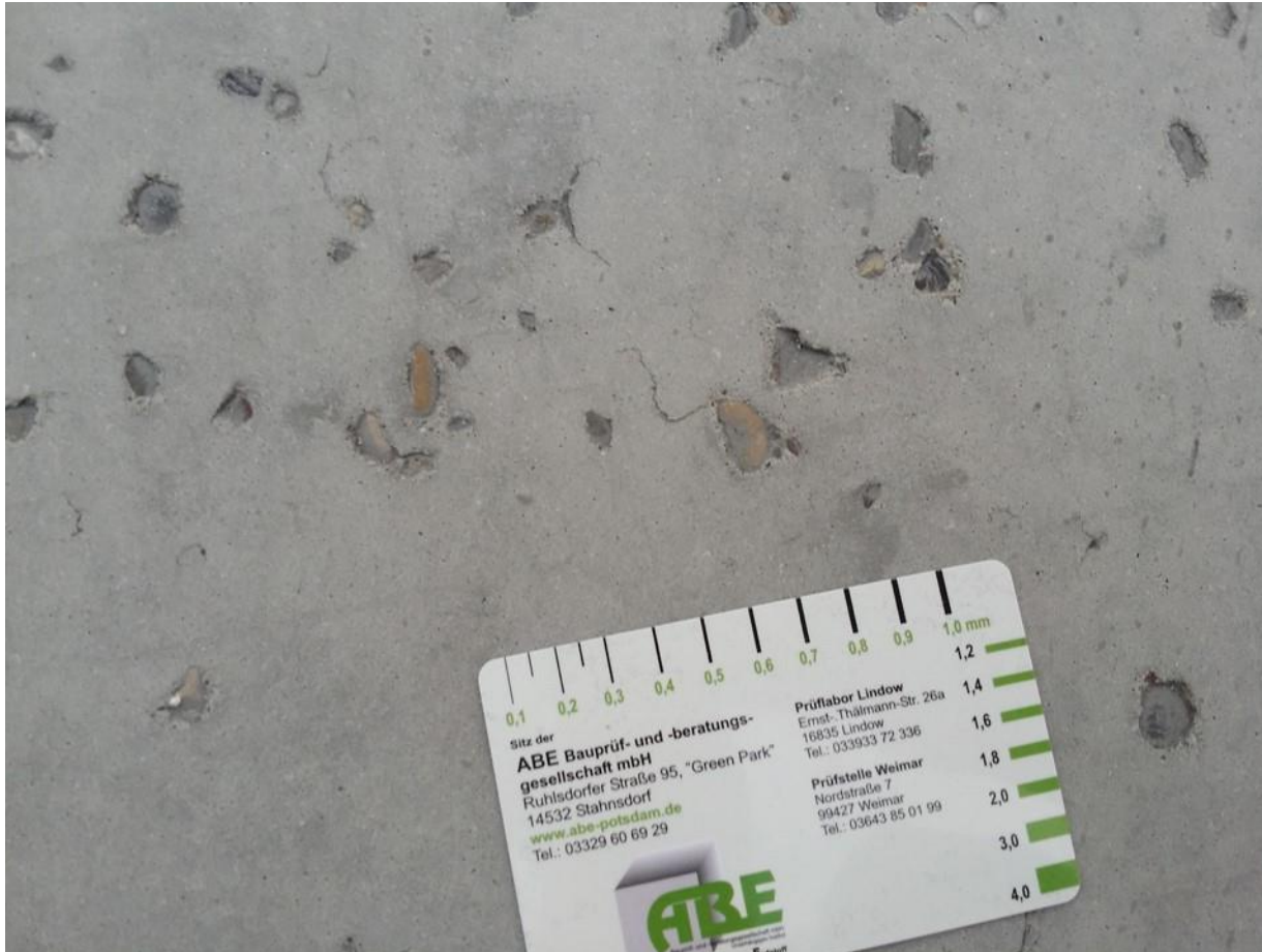
Abplatzungen über Gesteinskörnungen
