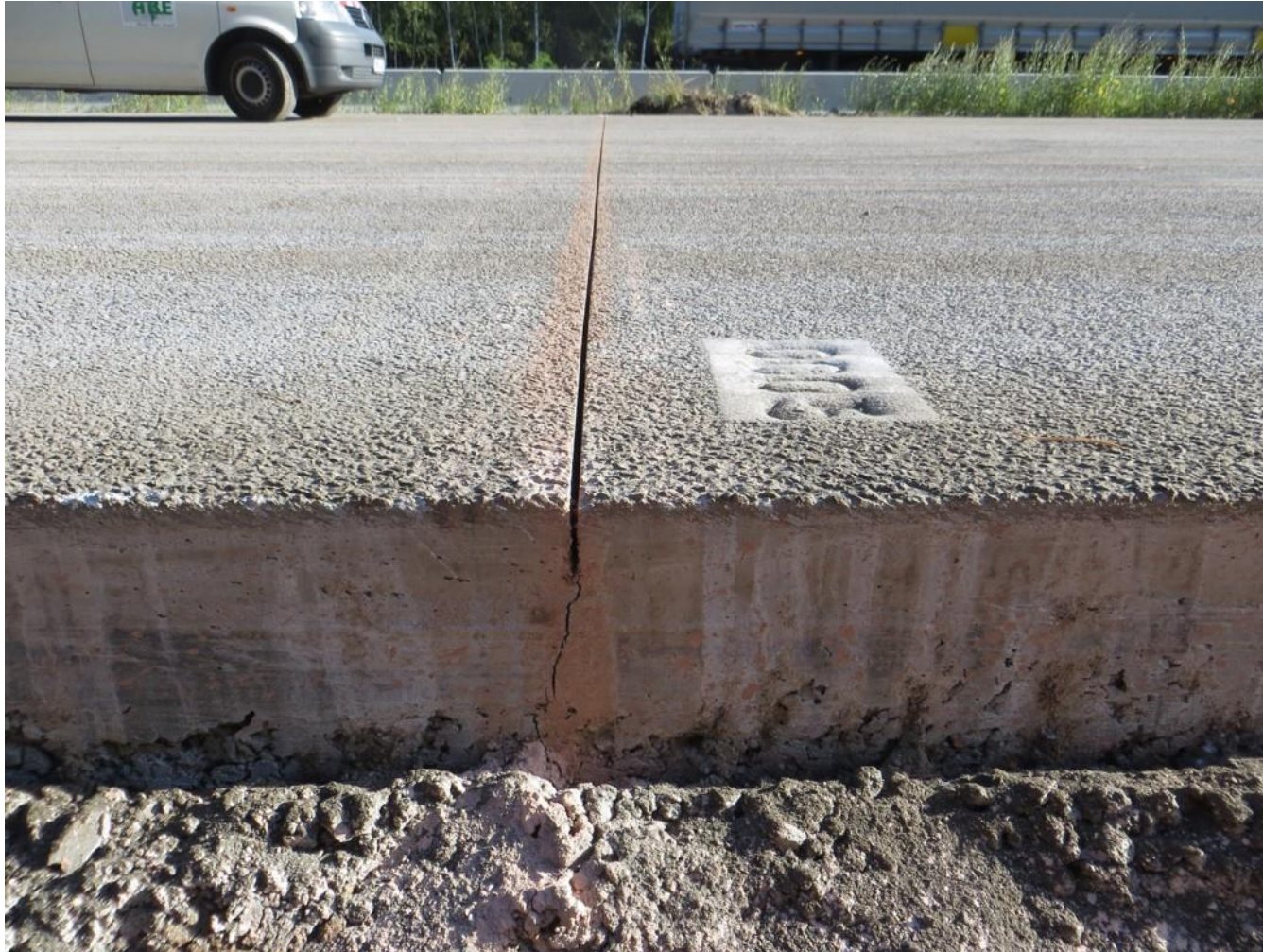
Kerbschnitt mit Riss
