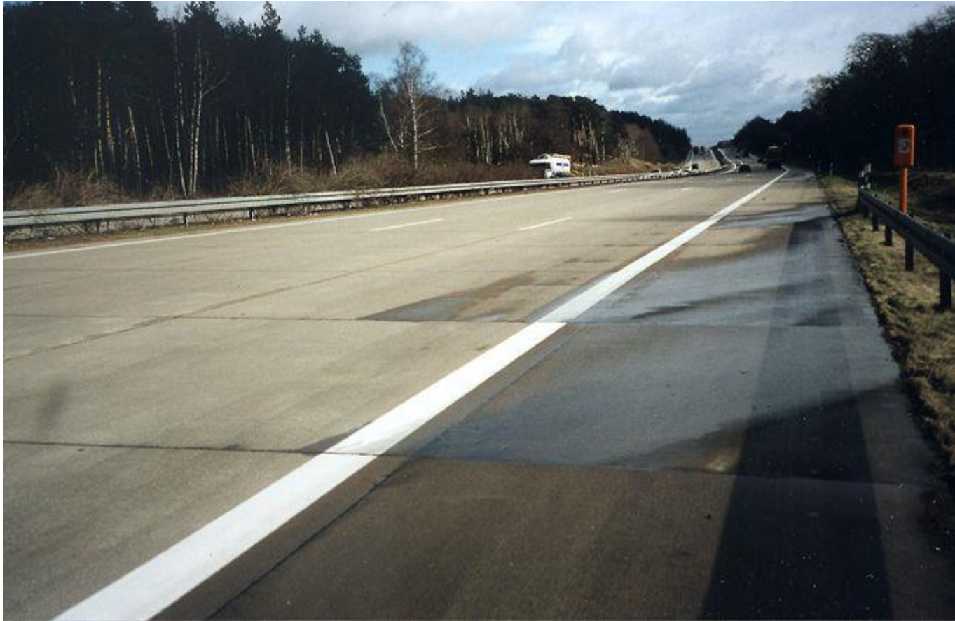
Wasseraustrittsstellen bei Verbundbauweise
