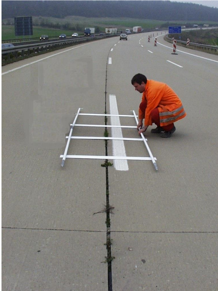
Längsscheinfuge nicht verankert
