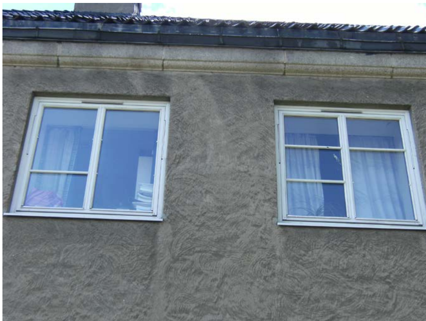
Løse sprosser faller ofte av etter noen år. Derfor må srossene være gjennomgående og med kittfals.
