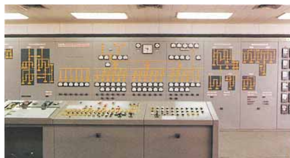
変電室制御盤
