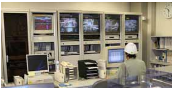
成形工場集中監視室
