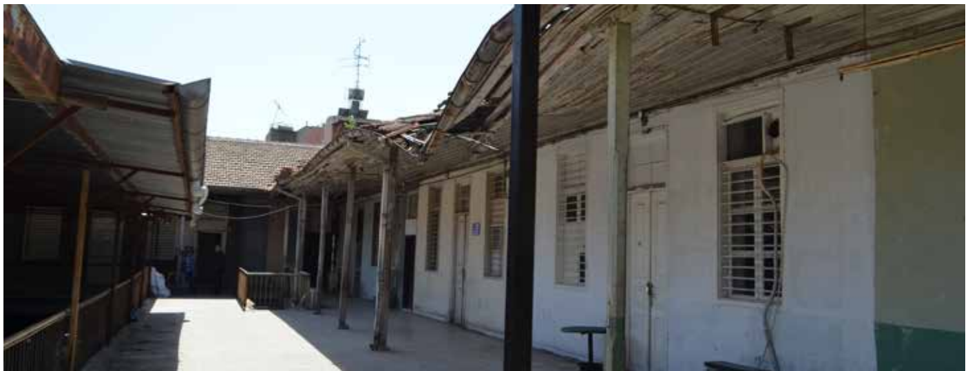
Nuri Has Pasajı'nın hasarlı durumdaki çatısı
