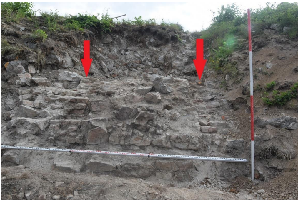
Obr. 45 Sekundárne zamurovaný otvor s naznačenými radmi tehál (autor).
