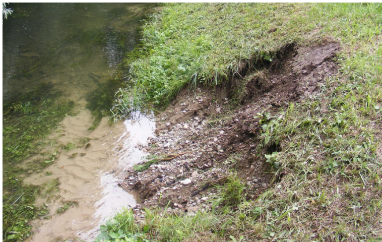
Bild 36: Oberflächennahe Rutschung an einer Seitengrabenböschung (Quelle: WSA Freiburg)
