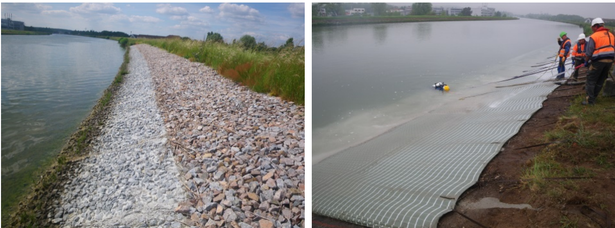
Bild 65: Beispielhafte Instandsetzung von schilfdurchwurzelter Asphaltbetondichtung am MDK mittels Betonmatten (Spezialmörtel in synthetischem Gewebe), vor (links) und nach (rechts) Einbau des Raudeckwerks (Quelle: WSA Nürnberg).
