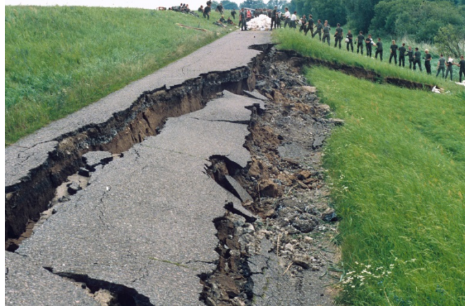
Bild 38: Böschungsbruch (Quelle: BAW)
