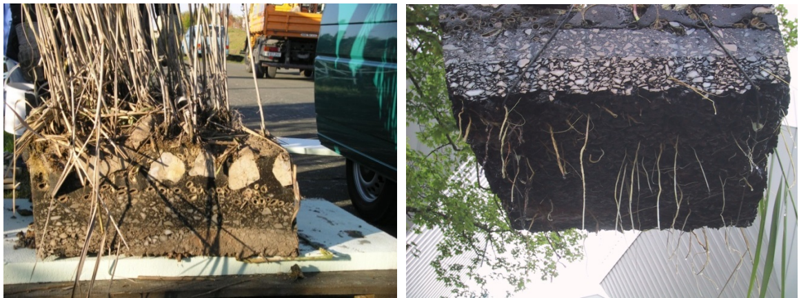
Bild 21: links: Entnahme einer mit Schilf durchwurzelter Asphaltbetondichtung am Main-Donau-Kanal (Quelle: WSA Nürnberg), rechts: durchwuzelte Asphaltbetondichtung (Quelle: BAW)
