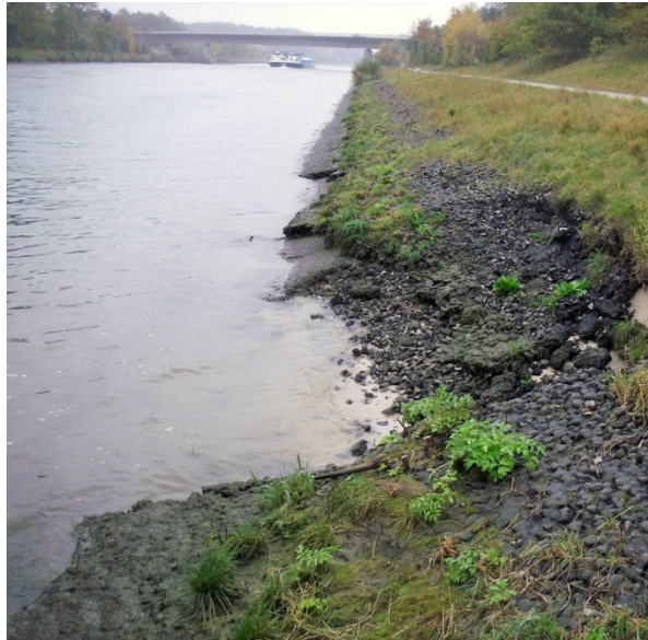
Bild 41: Verformungen Asphaltabdichtung (Quelle: WSA Nürnberg)
