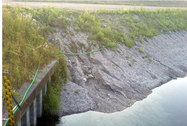
Bild 46: Oberflächenerosion durch Starkregen (Quelle: WSA Freiburg)
