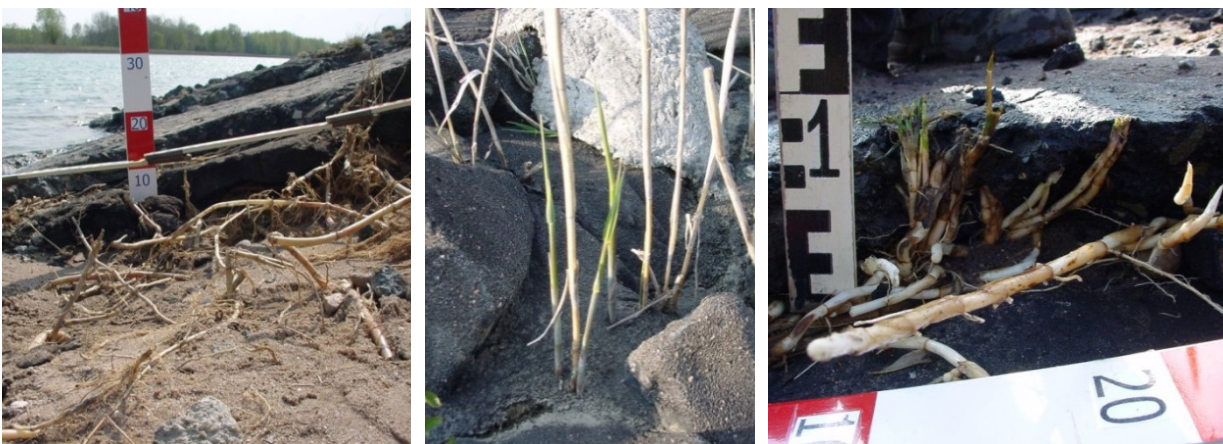
Bild 20: Schilf unter und in einer Asphaltbetondichtung am Elbe-Seiten-Kanal (Quelle: BfG)
