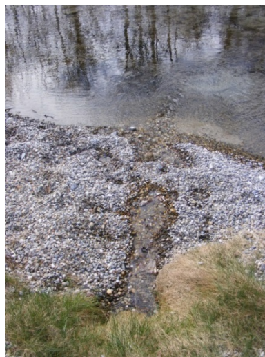
Bild 45: konzentrierte Ausströmung aus einem Erosionskanal (Quelle: WSA Freiburg)
