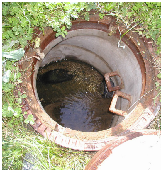
Bild 35: Kontrollschacht mit Zulauf aus Dränleitung (Quelle: WSV)
