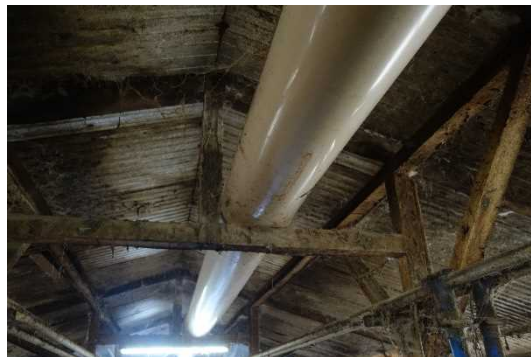
(右) 天井に設置してあるダクトファンにより空気を循環
