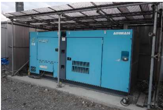
非常時の発電機
