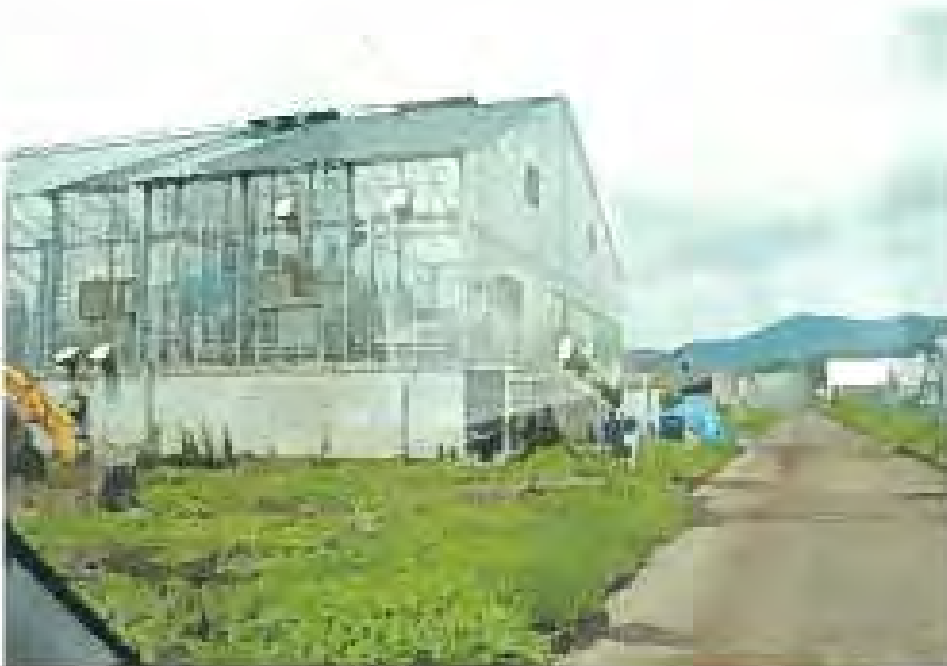
汚水処理施設「微生物処理施設」及び「オゾン脱色殺菌施設」
