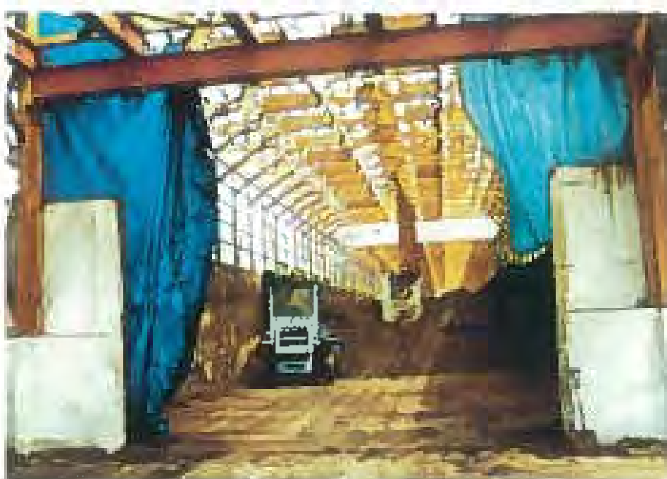
小坂クリーンセンター堆肥醗酵施設「資源-地域循環型」では、 豚糞堆肥化と合わせて町内の生ゴミも処理される。
