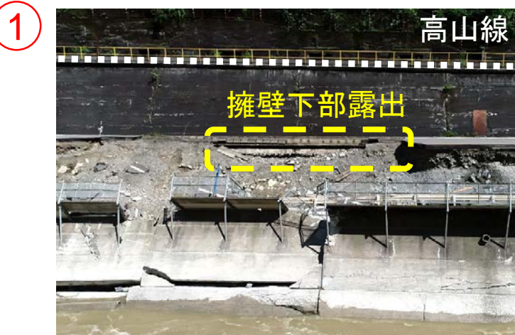
① 飛騨小坂駅～渚駅 111km600m付近 河川増水による線路擁壁下部の露出
