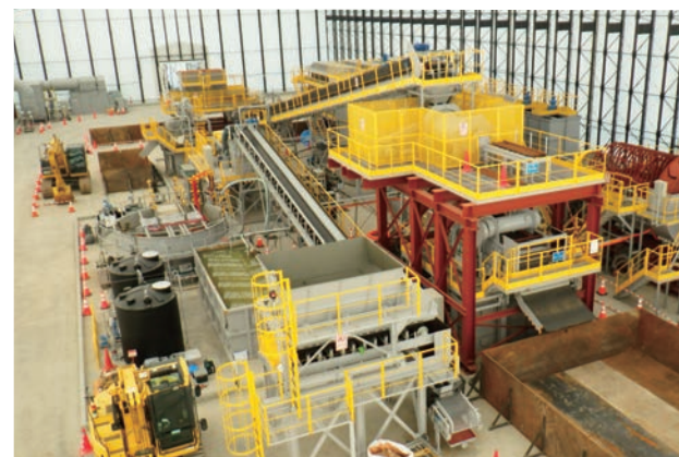
中間貯蔵施設内分級施設(大熊町)
