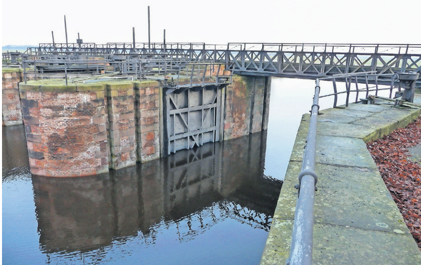
Die Schiffdorfer Stauschleuse im Jahr 2011.
