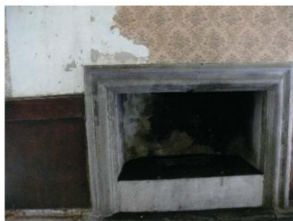
Intonaco sotto la tappezzeria
