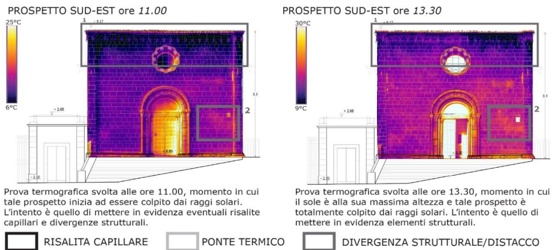
Figura 3. Analisi termografica eseguita sul prospetto principale della Chiesa di San Vito
