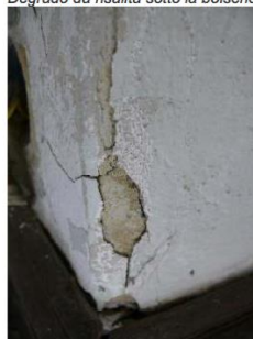
Distacchi di intonaco
