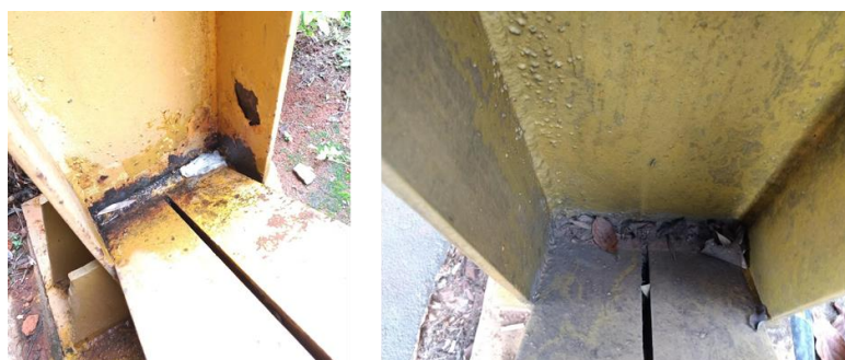
Figura 11. Presença de umidade e sujeira na junção do pilar com a diagonal maior. Fonte: De autoria própria.
