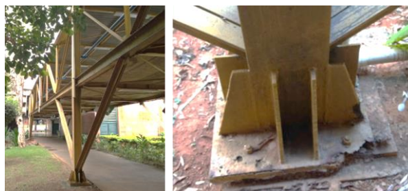
Figura 6. Detalhes do pilar encontrando diagonais em sua base e Ligações aparafusadas com o bloco de fundação. Fonte: De autoria própria.
