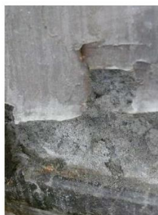
Degrado da risalita sotto la boiserie
