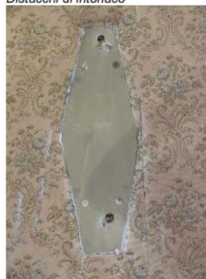
Tracce di impianti sotto la tappezzeria
