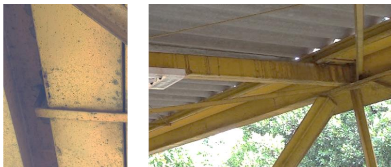
Figura 8. Presença de manchas na estrutura. Fonte: De autoria própria.
