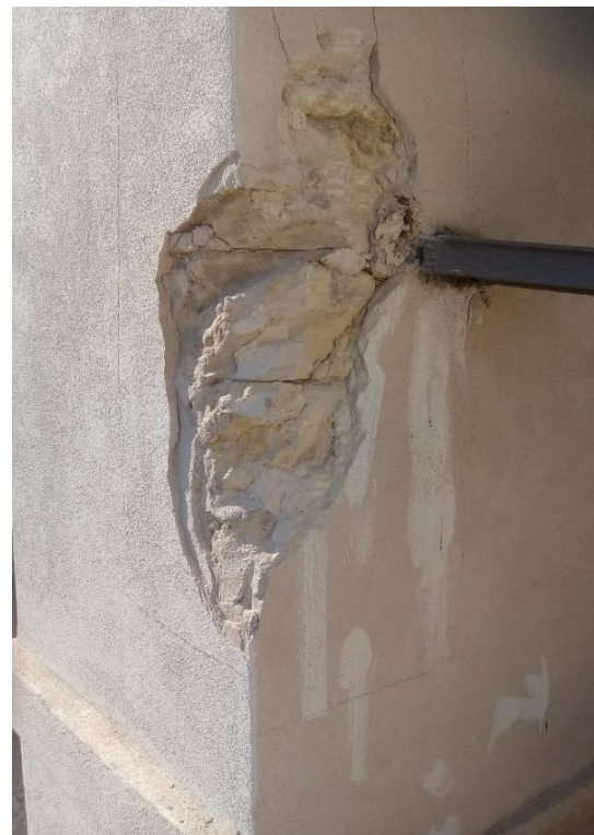
Figura 6. Stato della muratura ante intervento
