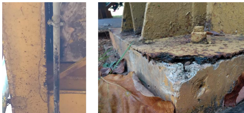
Figura 10. Banzo inferior apresentando manchas, falha na pintura e pontos de corrosão, placa de base com nível elevado de corrosão. Fonte: De autoria própria.
