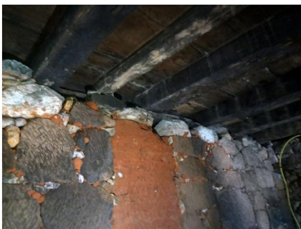
Figura 6. Detalhe das paredes em moledo no porão e do piso do pavimento principal. Fonte: Acervo dos autores, 2022.
