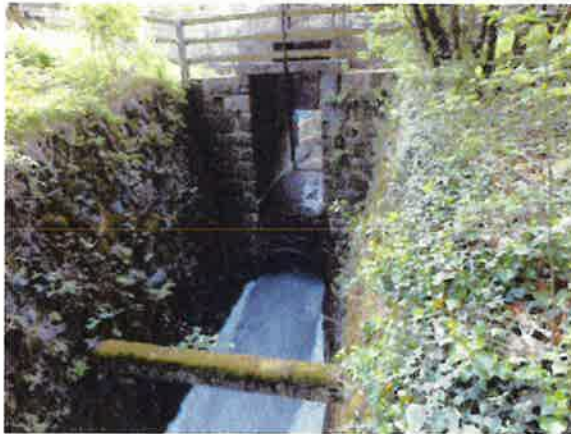
Bild 3 Auslauf Unterwasserkanal aus Zentrale
