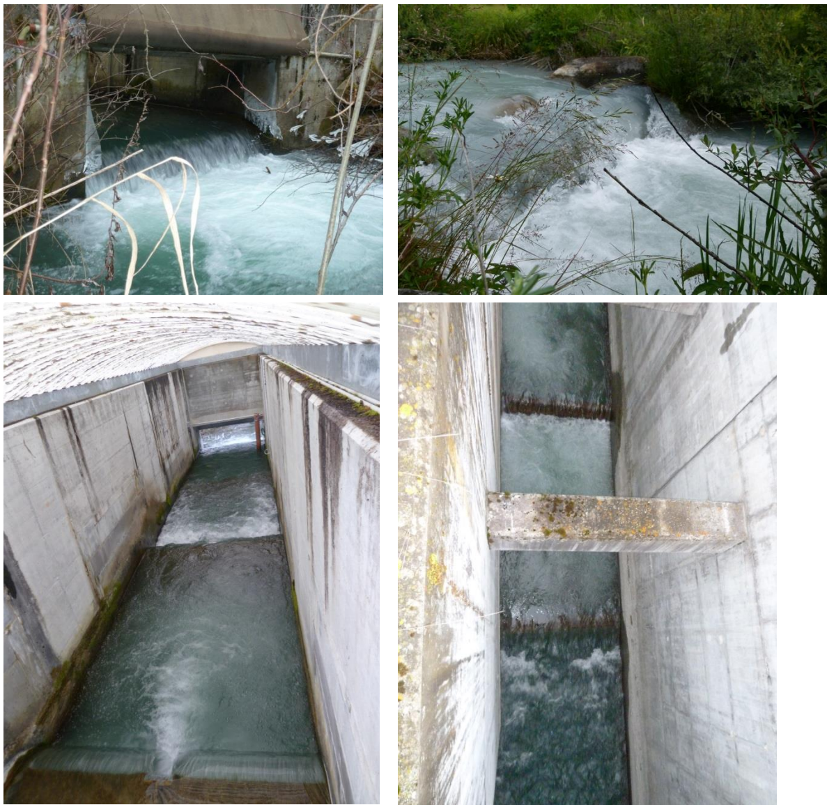
Abbildung 1 Oben links: Übergang Umgehungsgewässer in den letzten, technischen Abschnitt mit Absturz, oben rechts: einer der vielen Abstürze im Umgehungsgewässer, unten links: hydraulisch regulierbare Wehrklappen in letzten Abschnitt, unten rechts: Beckenpass im untersten Teil der Fischeaufstiegsanlage.
