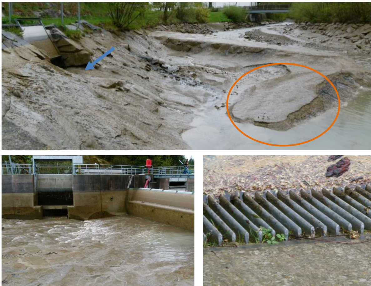
Abbildung 1 Oben links: Damm mit derzeit sehr wenig abgelagertem Material (orange eingerahmt), blauer Pfeil: Ausstieg aus der Fischtreppe. unten links: Lage des Rechens vor dem Einlaufbauwerk; unten rechts: Profil Feinrechen.
