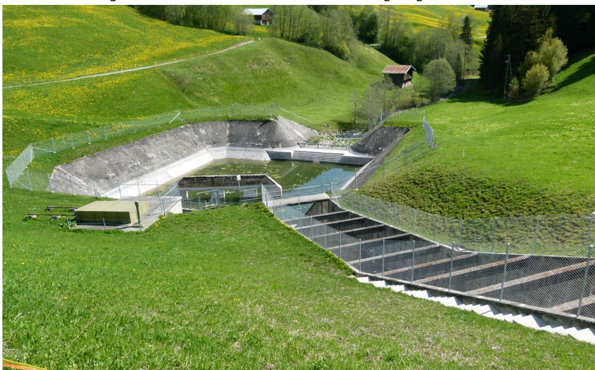
Abbildung 1 Tosbecken von wo aus die Fische weder zurück in den See noch abwärts in den Flem gelangen können.
