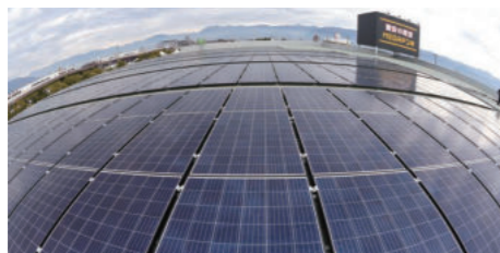
2022年6月現在、太陽光パネルを16店舗に設置 (写真はMEGAドン・キホーテ甲府店)
