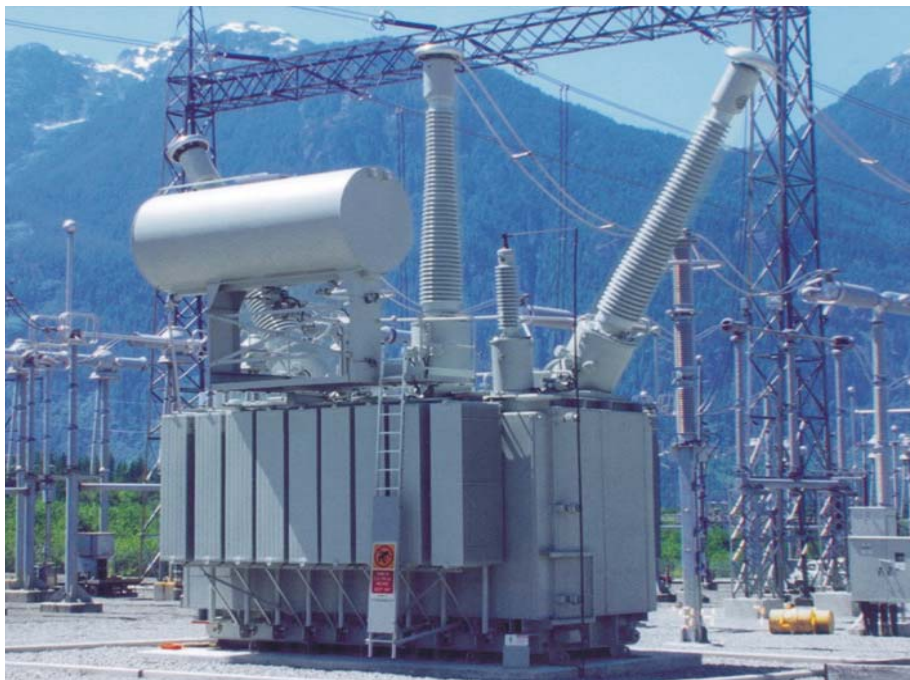
Bild 5.7. Blindleistungskompensations-Drosselspule 150 Mvar (Quelle: Siemens)
