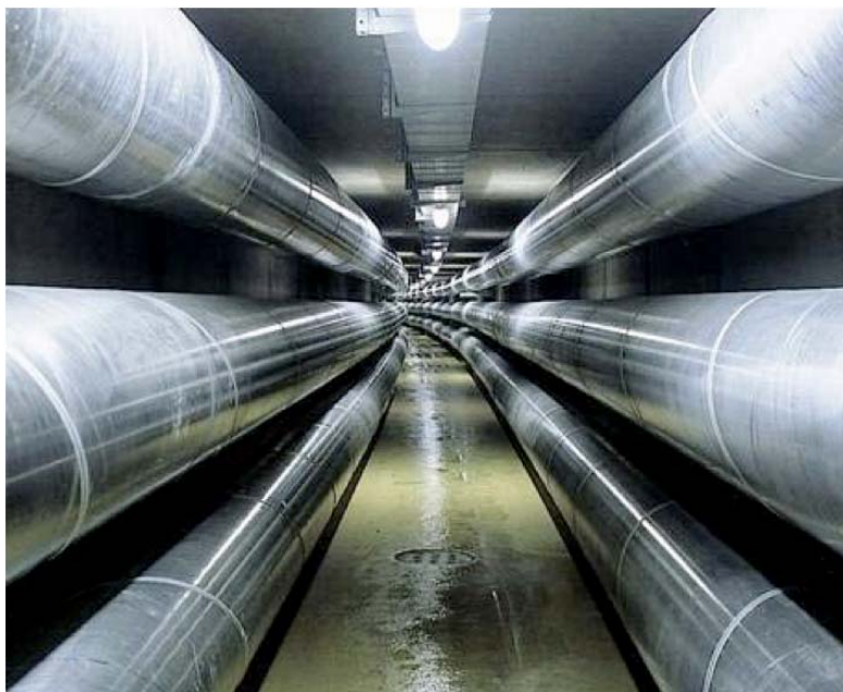
Bild 6.11. 380-kV-GIL-Doppelleitungssystem im Tunnel (Quelle: Siemens)
