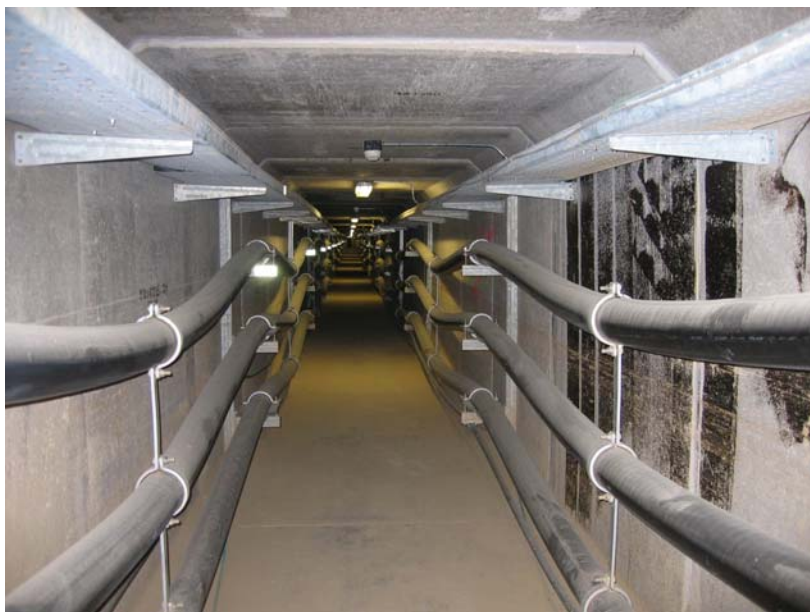
Bild 6.6. Kabeltunnel Flughafen Madrid
