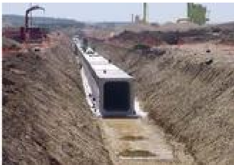
Bild 6.5. Kabeltunnel Flughafen Madrid
