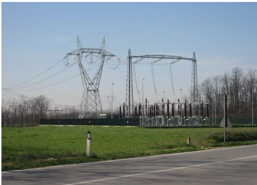
Bild 5.10. Endabspannmast und Portal am Übergang auf Kabel
