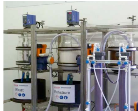
Phosphorrückgewinnung aus Klärschlamm, Technikumsanlage der Eurawasser Nord GmbH in Rostock. Quelle: Remondis
