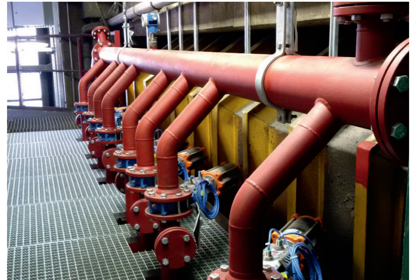
Klärschlamm-Mitverbrennung in der MVA Bielefeld (Klärschlamm-Verteilbalken), Quelle: Stadtwerke Bielefeld GmbH
