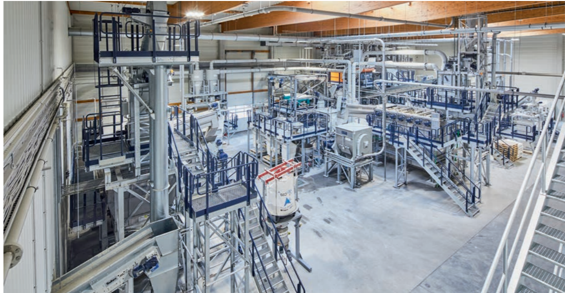
Anlagentechnik mit großem Wirkungsgrad, Quelle: REMONDIS
