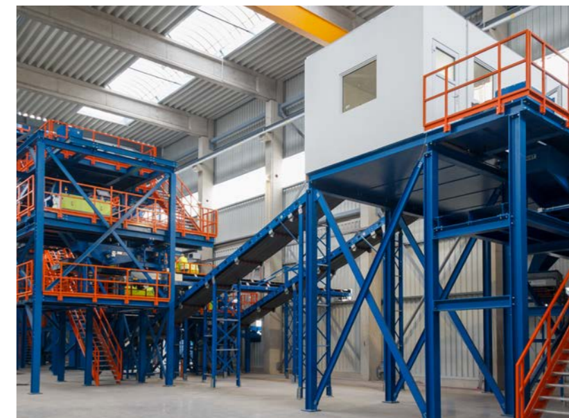
Sortieranlage für Glas, Quelle: REILING
