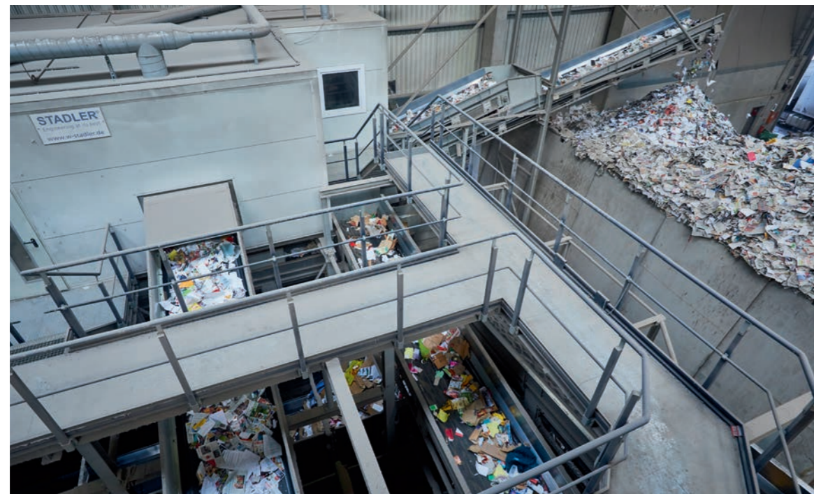
Sortieranlage, Quelle: REMONDIS
