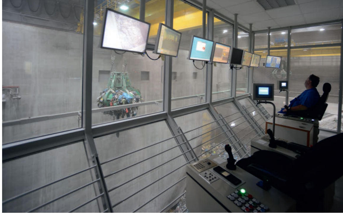
Müllheizkraftwerk Krankanzel, Quelle: BSR
