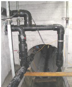
Abb. 5: Vor- und Rücklaufleitungen des WT in Binningen
