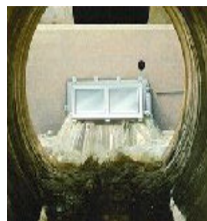
Abb. 22: automatische Schwallspülung für grosse Kanäle
