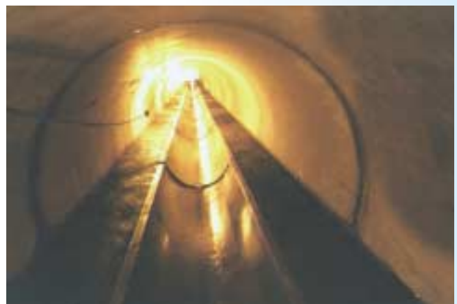
Der 200 m lange Wärmetauscher der Abwasserenergieanlage von Zürich-Wipkingen.
