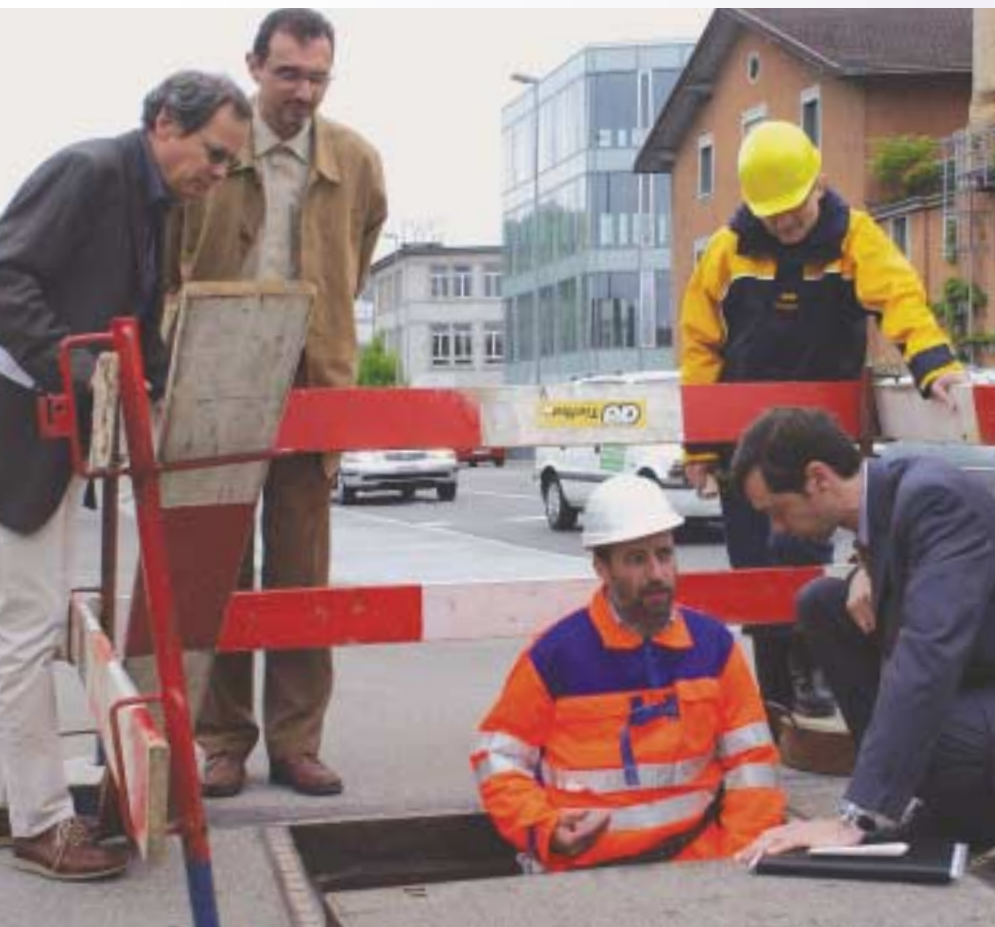
Schlüssel zum Erfolg: Abwasserenergieanlagen erfordern ein gutes Teamwork von Bauherrschaft, Kommune, Contractor, Kläranlagenbetreiber und Planer.
