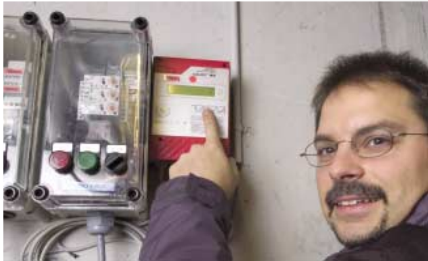
Martin Dietler, EBM Technik AG: «Zusammen mit dem Betrieb der Abwasser-Wärmepumpe übernimmt der Energiecontractor auch die individuelle Heizkosten- und Warmwasser-Abrechnung.»
