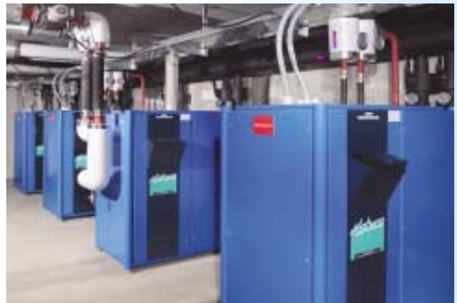
Aus 12-gradigem Abwasser wird 70-gradiges Heizwasser: Die Technik der Wärmepumpe macht es möglich. Foto Satag Thermotechnik
