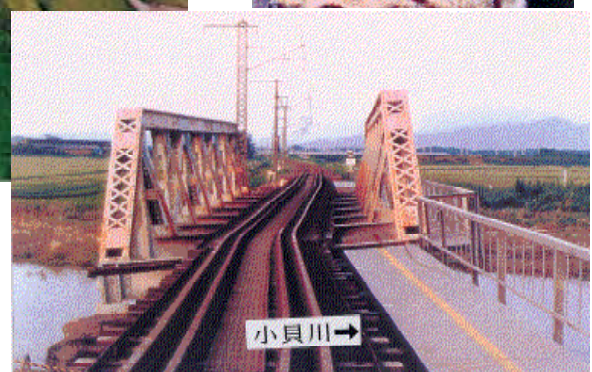
昭和61年8月出水で河床が洗掘されピアが2本被災し橋が傾いた。
