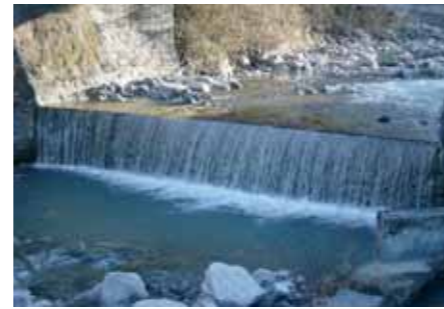
Solche Querverbauungen sind für praktisch alle Fische und Wasserlektiere unüberwindbare Barrieren. Die freie Wanderung ist unterbrochen.
