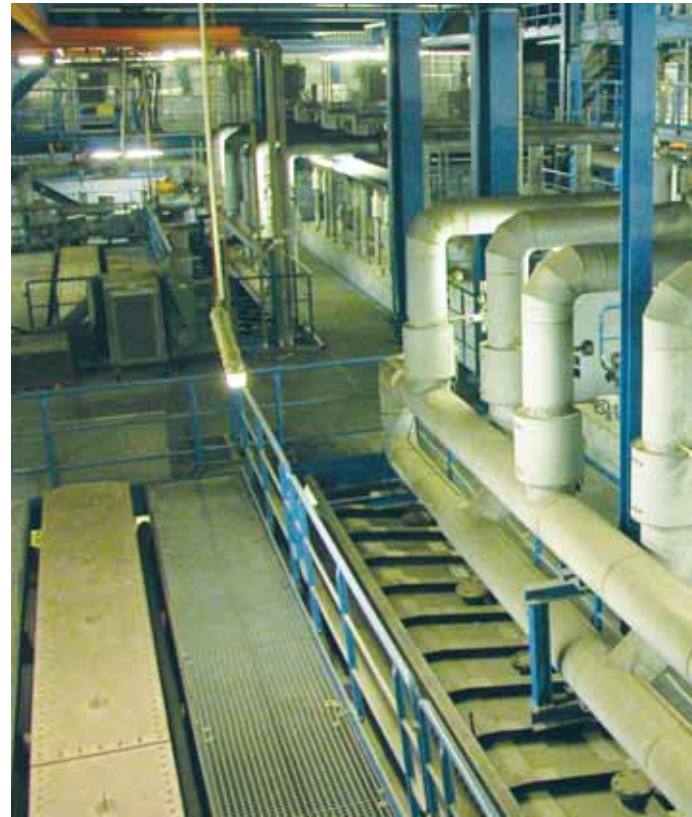
Umfangreiche und weitläufige Anlagen zur Rauchgasreinigung. Ein Blick über die Entschwefelungsanlage im Block 2.
