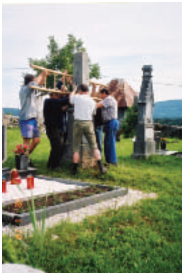
Topli Vrh, prenova kape zvonika, foto Hans Jaklič, 2004 Untertappelwerch, Erneuerung der Turmkappe / Topli Vrh, renovating the top of the belfry
