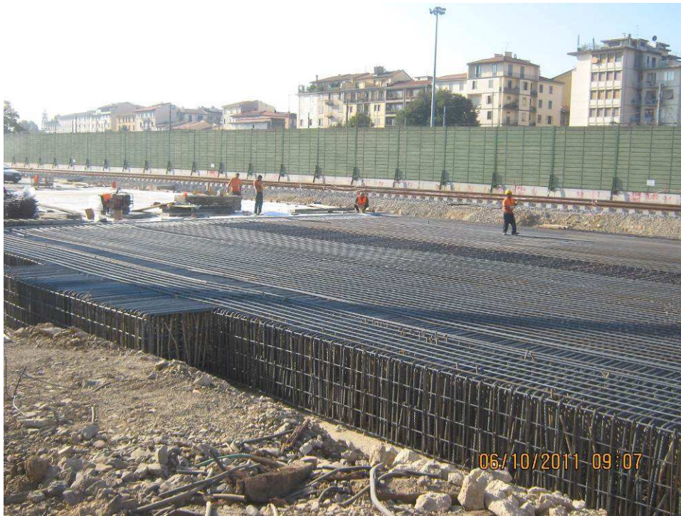
FOTO 4 – Galleria Artificiale - continuano le attività di armatura e getto della soletta di copertura
