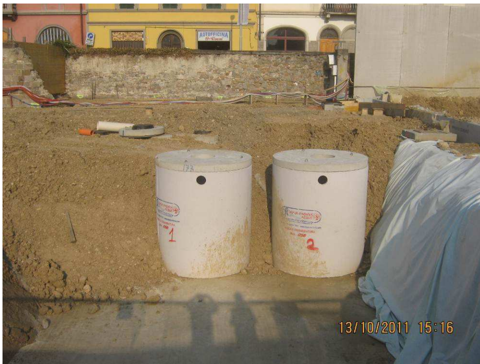
FOTO 7 – Allestimento impianto di trattamento delle acque
