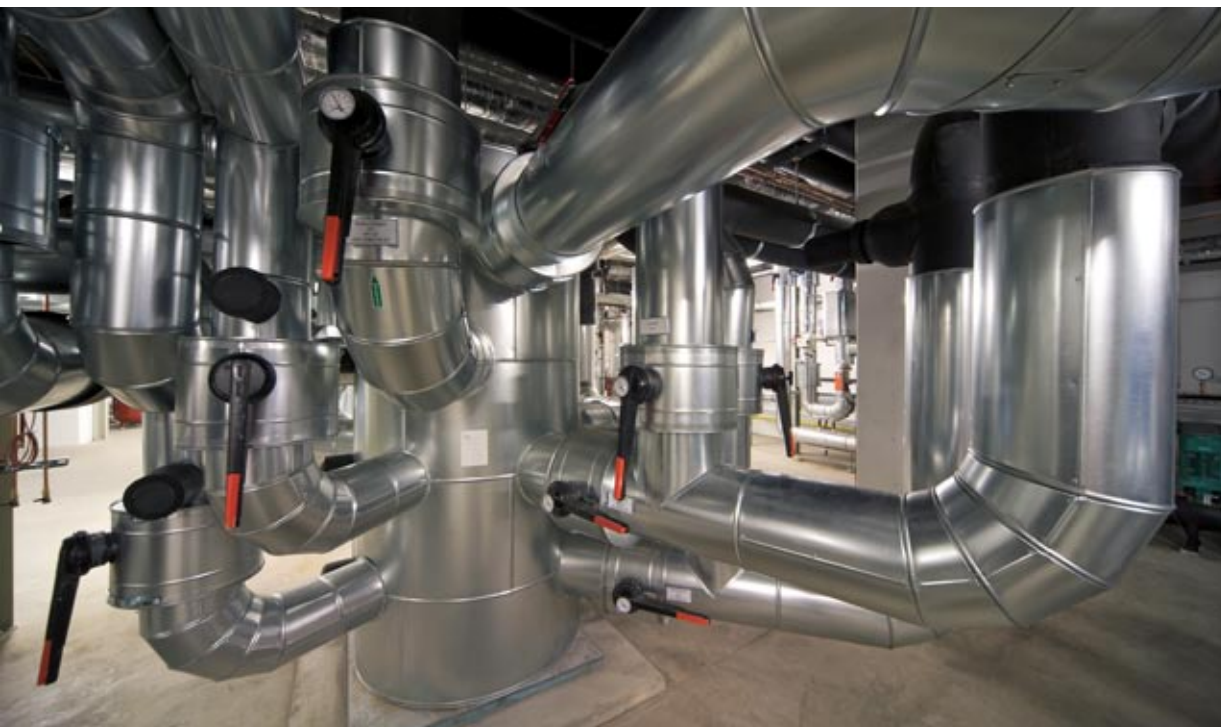
Geothermieanlage in der Praxis
